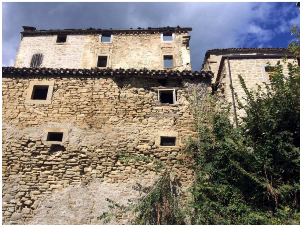
Fig. 2 - Borgo Cornaloni (Vincolo D.M. 25 marzo 1970) Borgo antico con promiscuità di fabbricati in parte con evidenti crolli e (in rari casi) di fabbricati di recente ristrutturazione. Il fabbricato della foto è assoggettato ad un intervento di ‘smontaggio controllato’ da parte della Soprintendenza.
